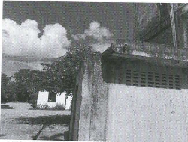
Vigas com perigo iminente de vir a ruína
